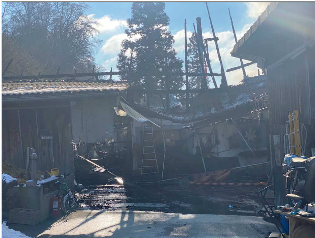
Der Schopf wurde vollständig zerstört.
