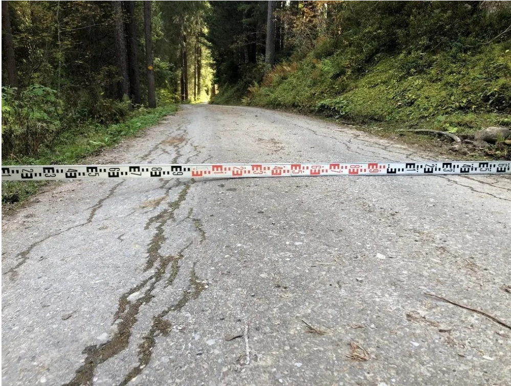
Auch hier im Gebiet zwüsche Gräbe ist die Strasse in keinem guten Zustand.Foto: PD
