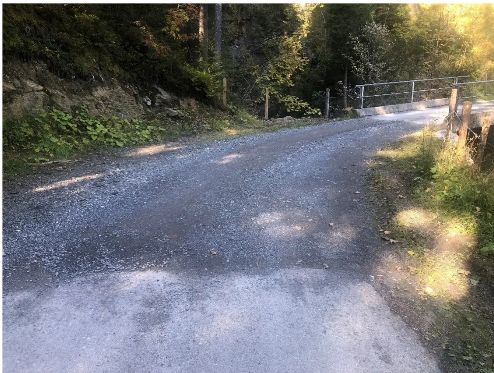
Hat eine Sanierung nötig: Die Traubachstrasse in Habkern: Hier ist die Strasse bei der Blattenbrücke zu sehen. Foto: PD
