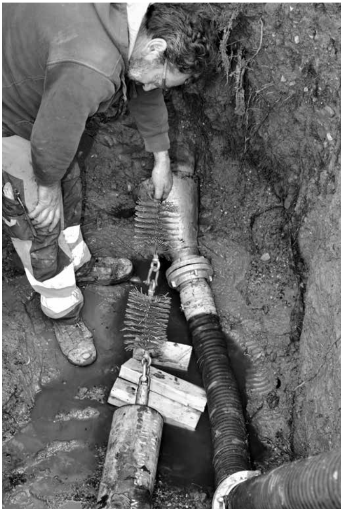
Vor der Reparatur, wird noch einmal eine Stahlbürste durch das Rohr gezogen, anschliessend mit dem «Molch» getrocknet
