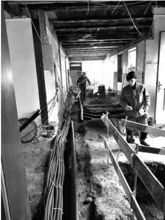
Elektrorohre soweit das Auge reicht
