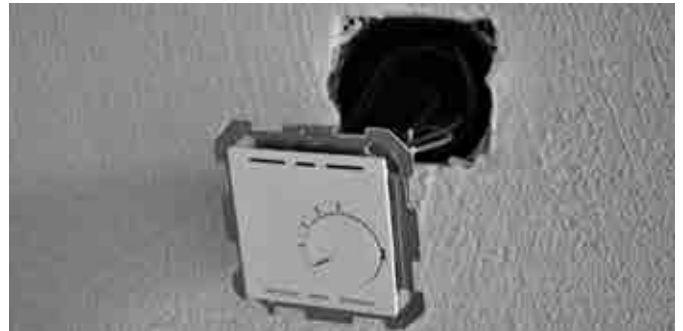
Dieser Thermostat muss noch montiert werden
