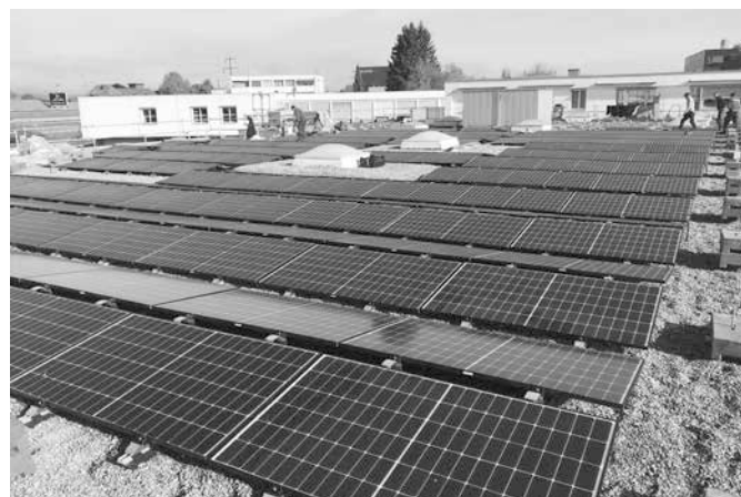
Bald wird hier Strom produziert
